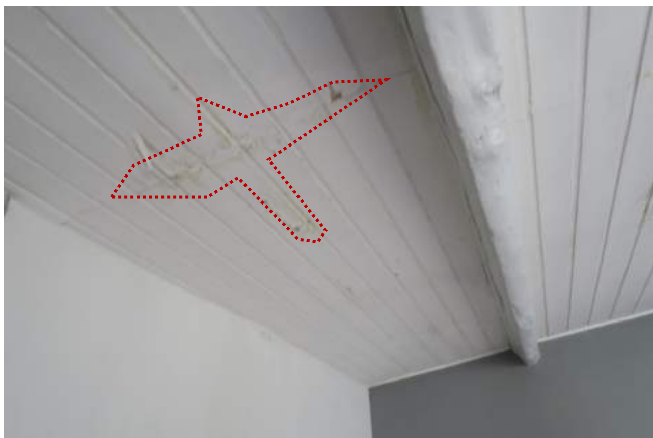
Vues moisissures plafonds lattis locaux R+3 sous pan de couverture Sud
