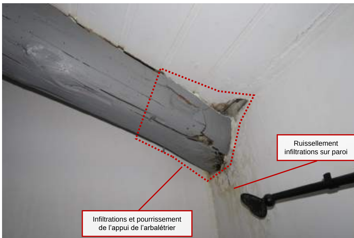
Vues locaux R+3 sous pans de couverture Ouest poutre bois cassée
